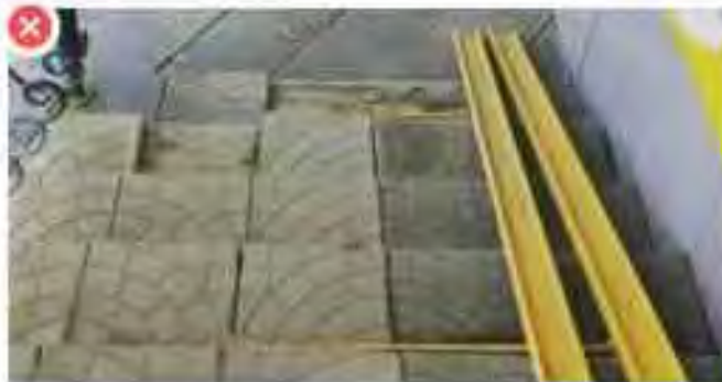
Лестница не соответствует правилам безопасности
