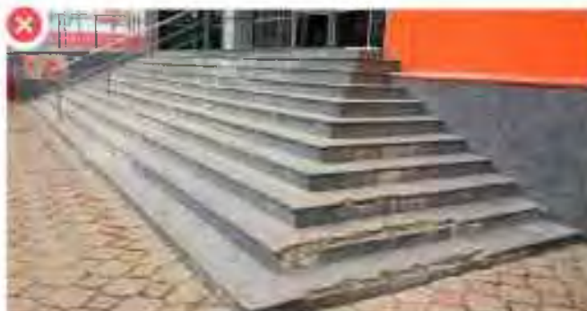
Лестница не соответствует требованиям безопасности: отсутствуют необходимые поручни, конструкция имеет повреждения и требует ремонта
