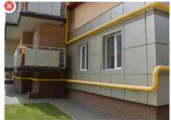
Запрещено использование яркого желтого цвета на жилом здании
